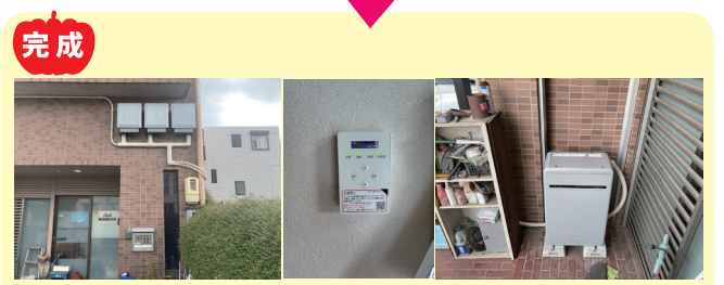
設置完了後、太陽光パネルと連携が上手くいっているかなど確認し終了になります。
